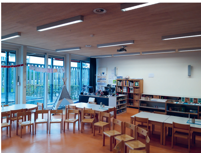
Unten: Schulzimmer der Basisstufe im Erdgeschoss mit Drallausslässen in der abgehängten Decke. (Quelle: FHNW)
